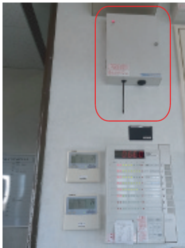
写真4 事務所に設けられた無線ユニット
