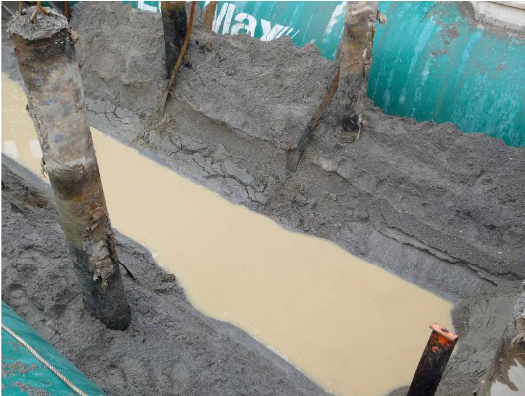
写真3. 2. 2 タンク撤去後の碎石基礎の状況（新潟県の営業用給油取扱所）
