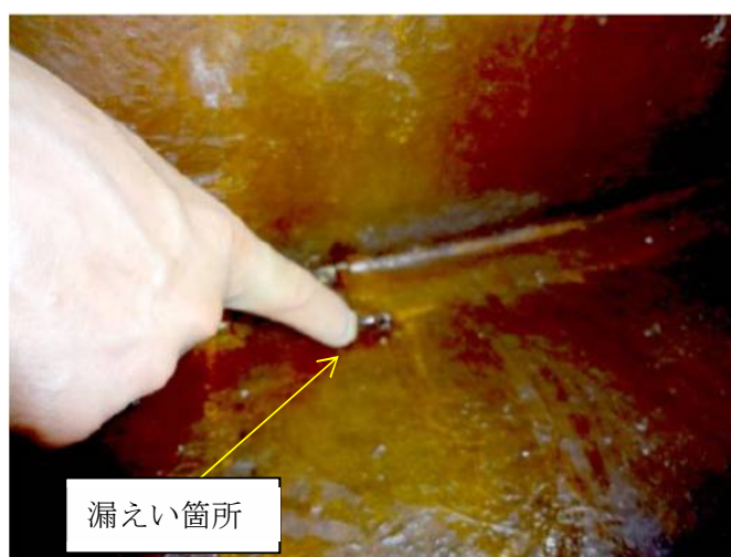
写真 2. 2. 2 KHK1366漏えい箇所
