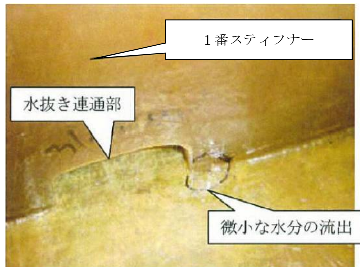
写真2. 2. 7 KHK660漏えい箇所（スティフナーNo. 1）
