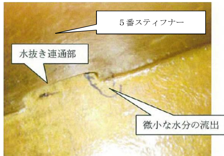
写真2. 2. 8 KHK660漏えい箇所（スティフナーNo. 5）
