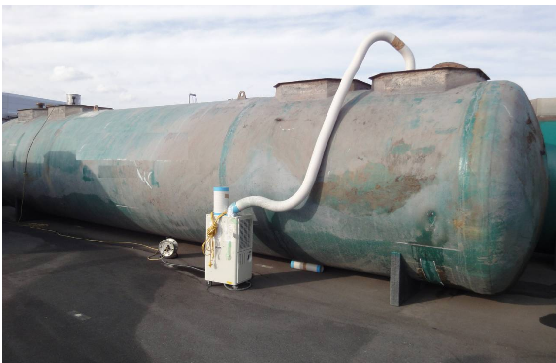
写真3. 6. 1 神奈川県破損タンク外観
