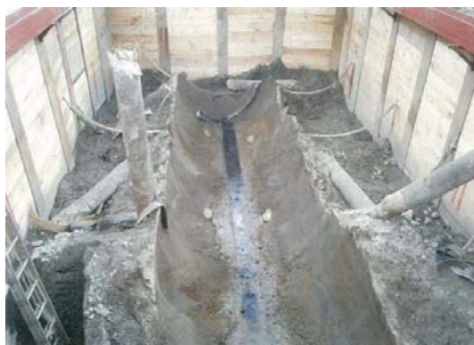
写真 2 倒壊した支柱
