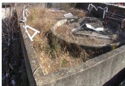
写真 2.1.3 タンクが流された屋外タンク貯蔵所
