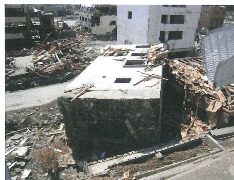
写真6.2.1-5 4階建て杭基礎建築物の転倒
