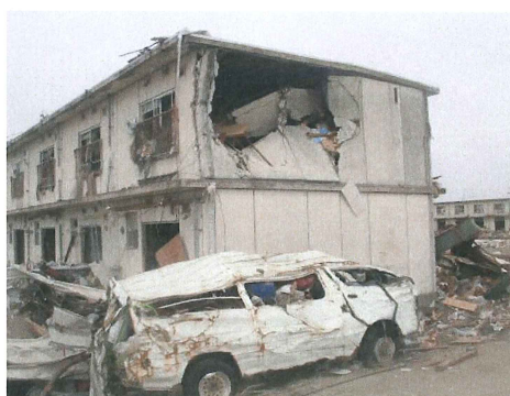
写真6.2.1-15 漂流物の衝突により生じた壁の開口
