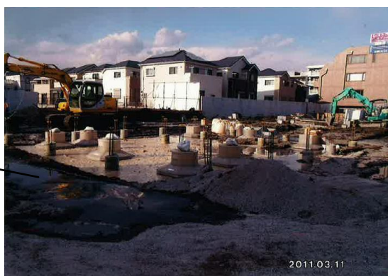
タンク埋戻し部分は液状化していない ※新設中のため上部スラブ施工前
