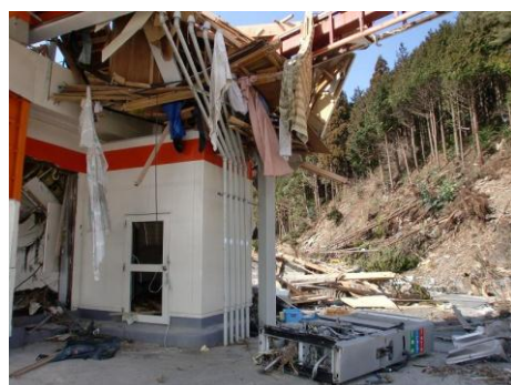
写真 2.2.9 流された固定給油設備 (日本ガソリン計量機工業会提供写真)
