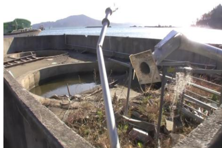
写真 2.1.4 タンクが流された屋外タンク貯蔵所
