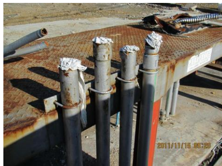
写真 2.2.12 上部が欠損した通気管
