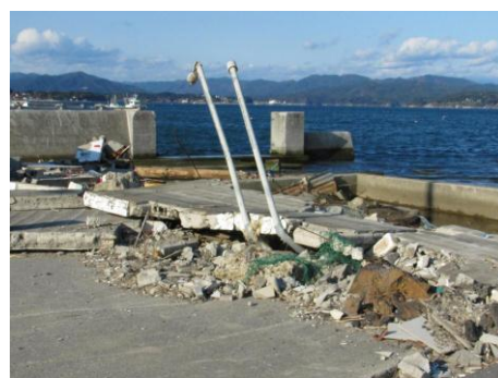
写真 2.2.15 倒壊した防火塀とともに変形した 通気管
