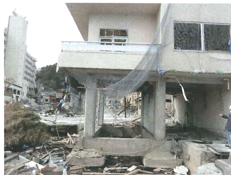
写真6.2.1-9 洗掘による基礎の露出
