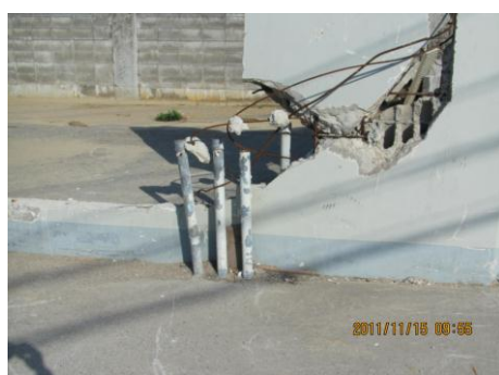
写真 2.2.10 上部が欠損した通気管
