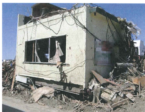
写真6.2.1-2 2階建て建築物の層崩壊
