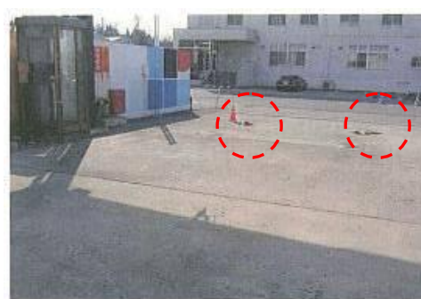
写真 2.2.2 タンク浮上 (赤丸点線：マンホールから配管が飛び出している)
