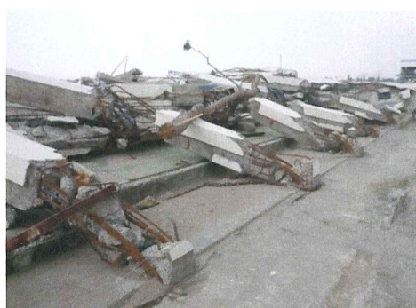
写真6.2.1-1 2階建て建築物の倒壊
