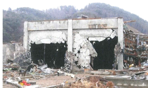
写真6.2.1-12 非構造壁の面外破壊
