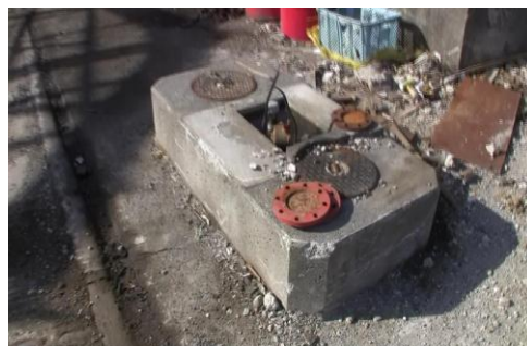
写真 2.2.7 固定給油設備が欠損したアイランド
