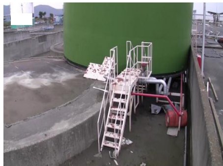
写真 2.1.2 滑動した屋外貯蔵タンク
