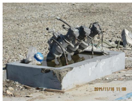
写真 2.2.17 上部が欠損した注入口
