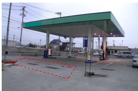
写真 2.2.3 タンク浮上被害のあった給油取扱所 (赤線点線部分のタンクが浮上)
