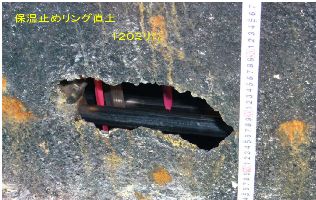
図 3.1-10 腐食開孔部の位置
