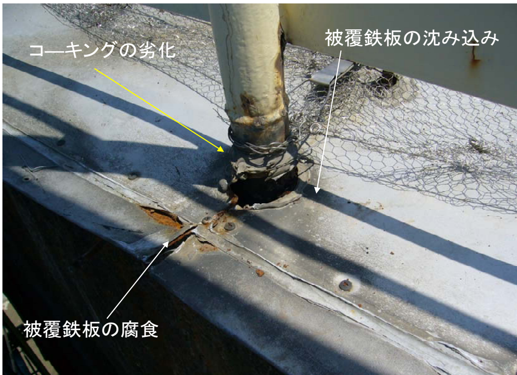
図 3.1-6 保温施工の劣化（屋根板）
