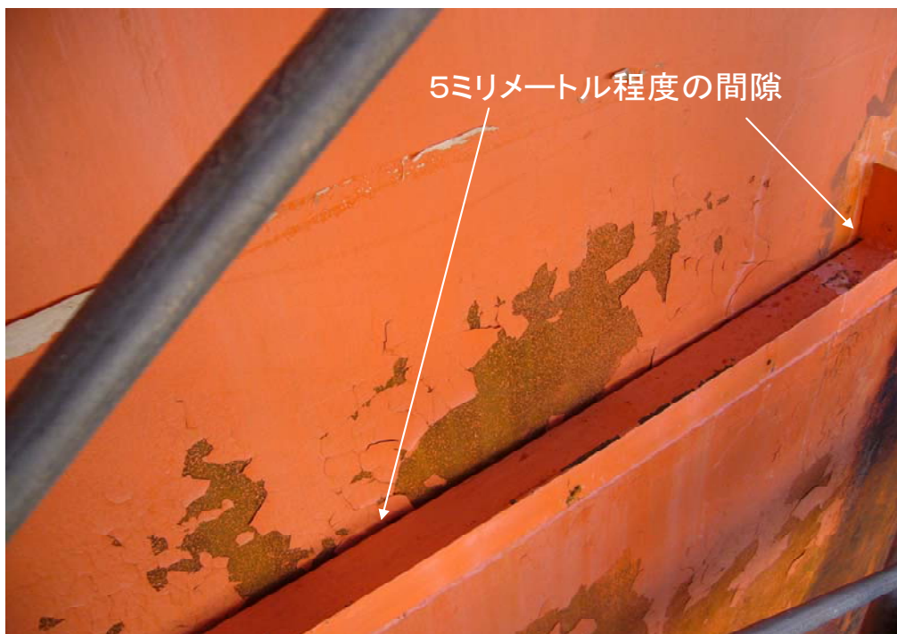
図 3.1-16 保温材止めリングの間隙
