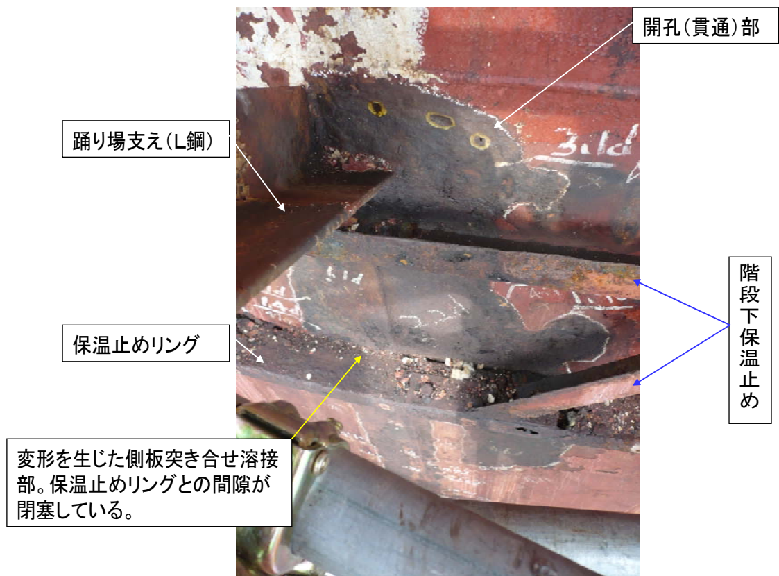
図 3.1-20 腐食開孔部付近の状況
