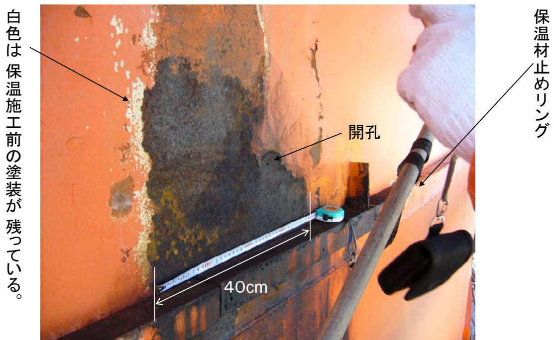
図 3.1-15 保温材止めリング直上部の腐食
