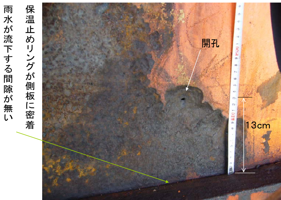
図 3.1-17 腐食開孔部の詳細
