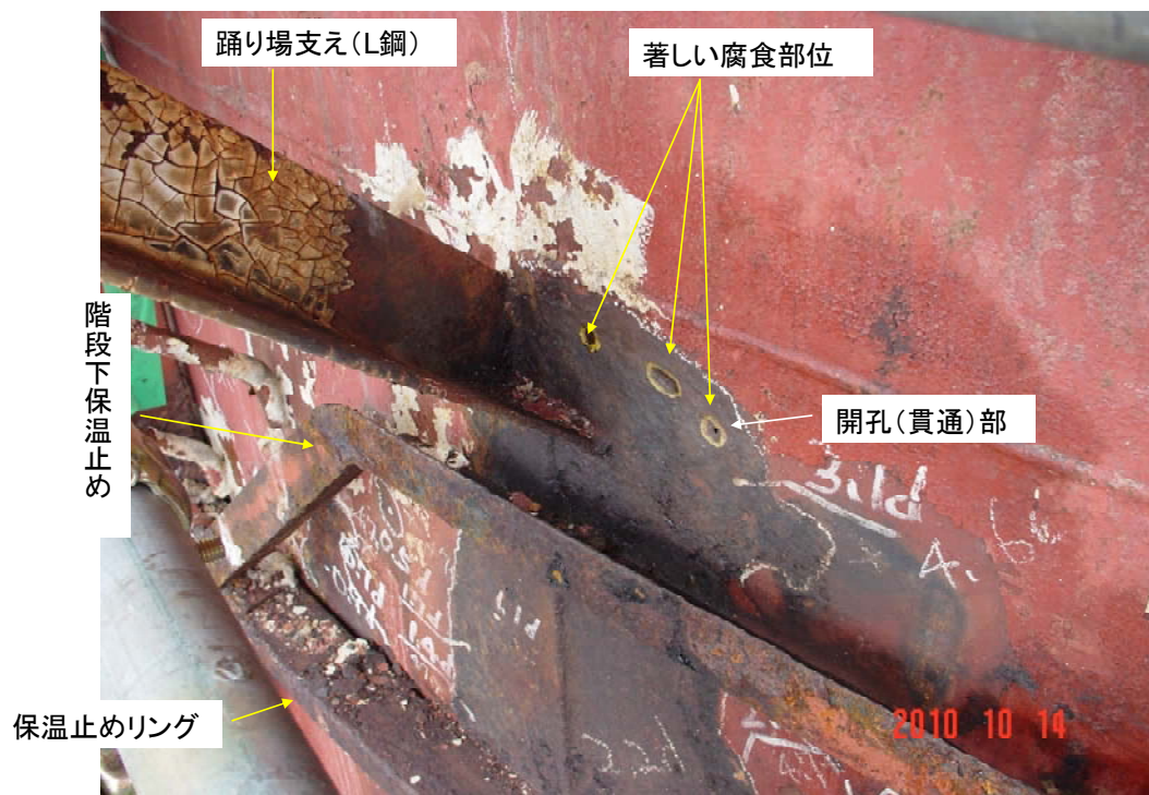
図 3.1-21 腐食開孔箇所
