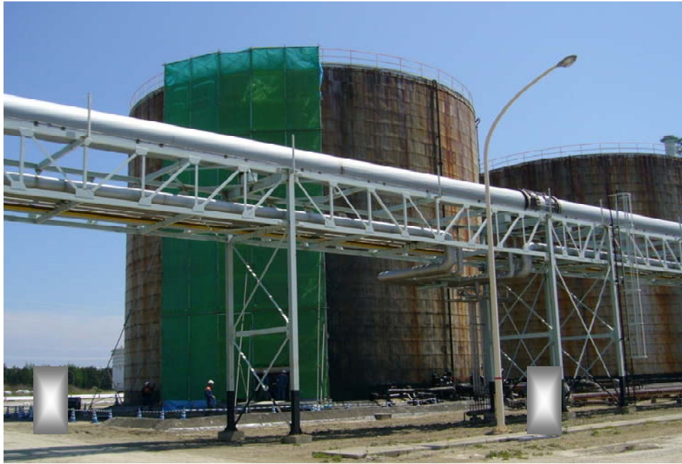
図 3.1-1 タンクの外観
