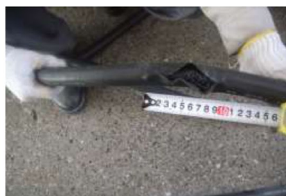
写真5 ノズルNo.3の給油ホース損傷状況
