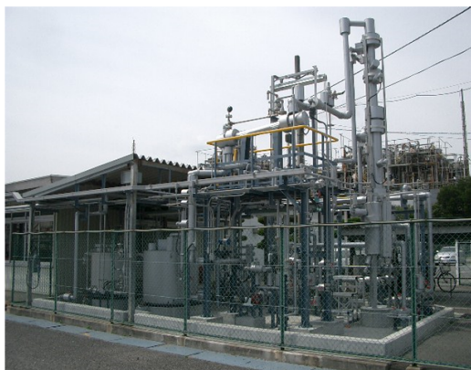
蒸留実習設備全景
