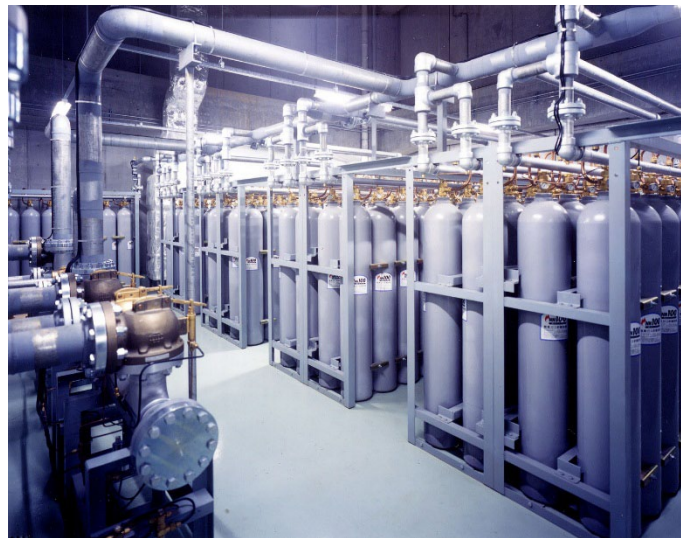
写真1 消火剤貯蔵容器
