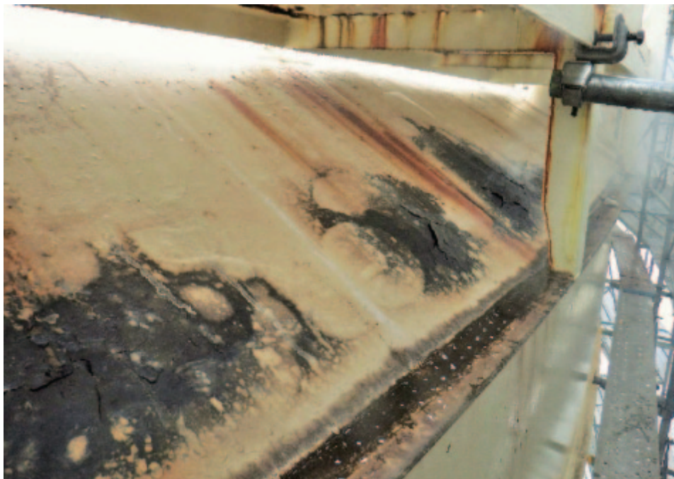
屋根の煤けの状況
