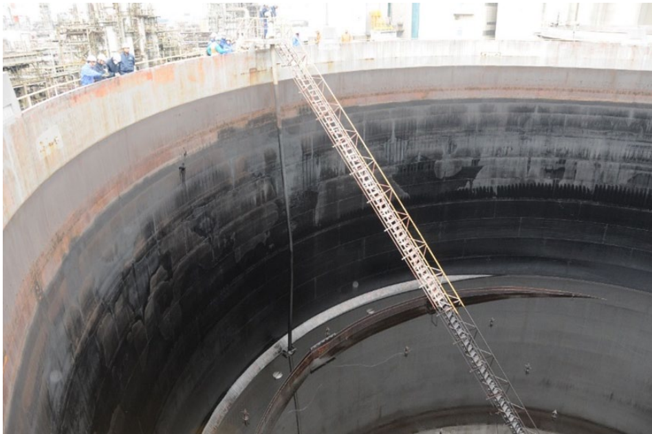
図2 平成23(2011)年東北地方太平洋沖地震の際の重油タンク浮き屋根沈没事故(川崎市)
