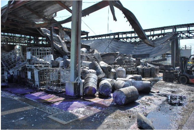
写真4 倒壊建築物と散乱する危険物・容器
