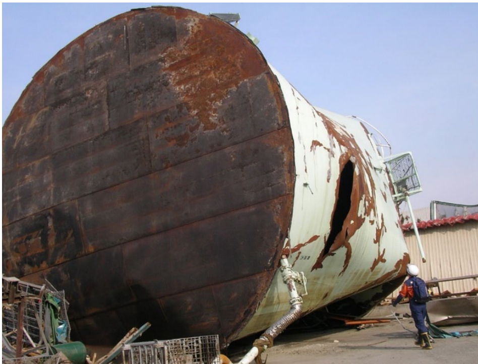
図1 平成23(2011)年東北地方太平洋沖地震の際の石油タンクの津波被害(気仙沼市)
