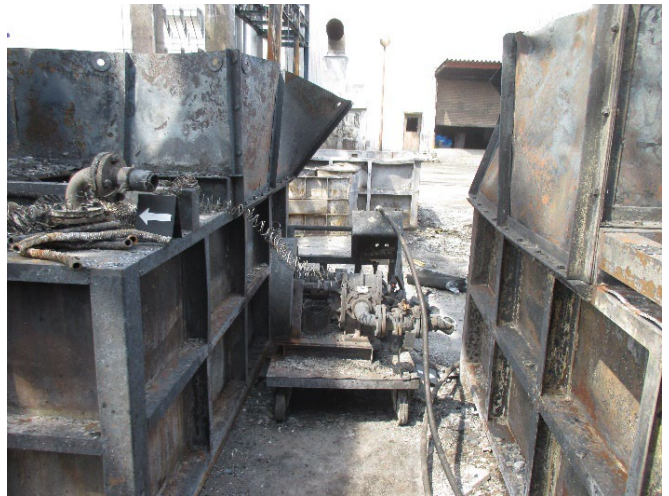
写真10 油槽に挟まれたポンプ
