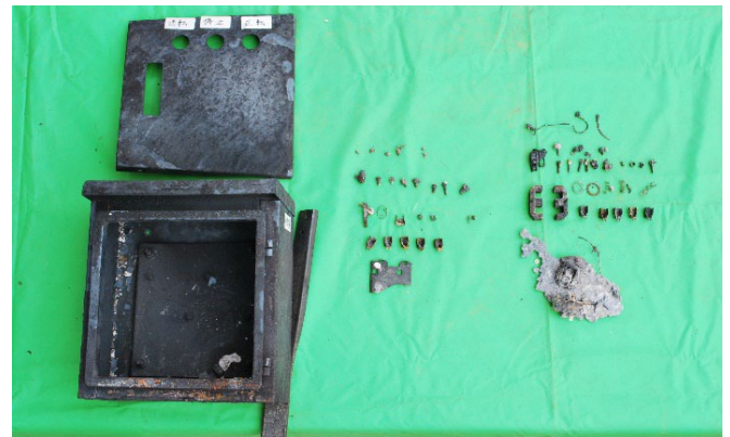
写真18 ポンプ制御盤
