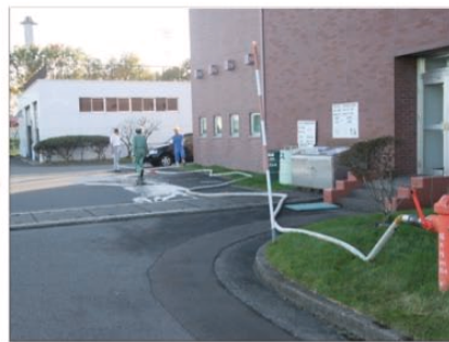
消火栓より工業用水を供給
