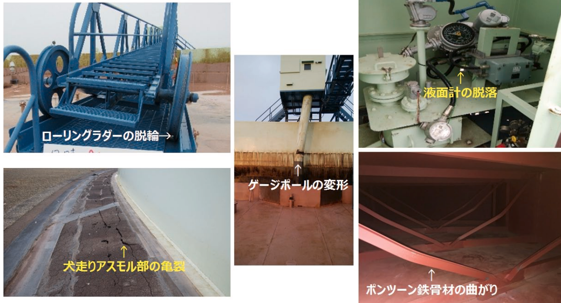
写真2 原油タンクの被害状況
