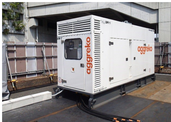
写真2 キャノピー型発電機（320KVA）
