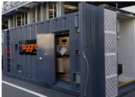
写真1 コンテナ型発電機（1500KVA）
