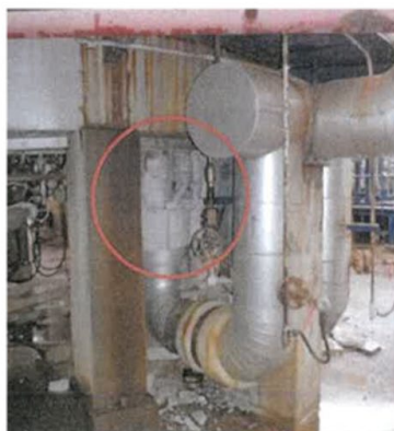
配管の保温・板金剥離
