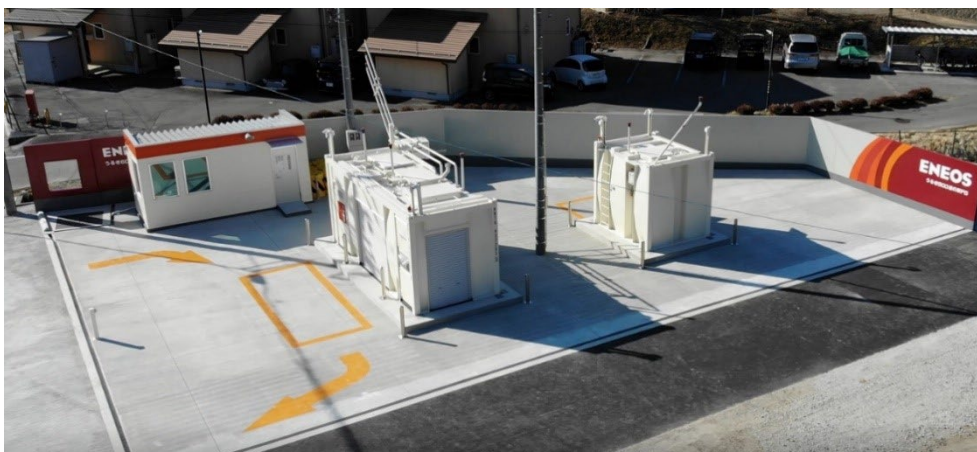
写真 2-4 南信州売木村コンテナ型給油所
