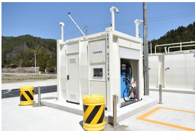
写真 2-3 コンテナ型給油所10ft 灯油 (8.1kℓ)
