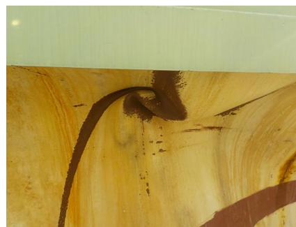
(写真9) 西側トップアングル付近変形
