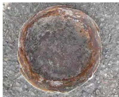
(写真15) 東側通気管引火防止網内側
