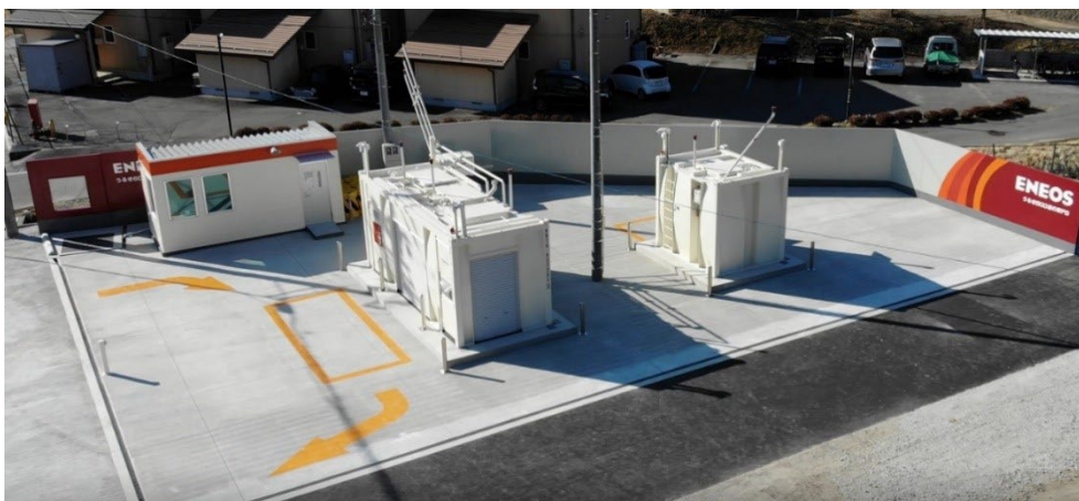
写真 2-4 南信州売木村コンテナ型給油所
