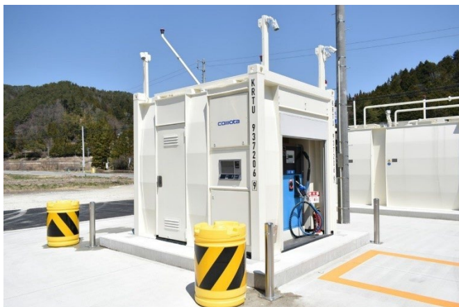
写真 2-3 コンテナ型給油所10ft 灯油 (8.1kℓ)
