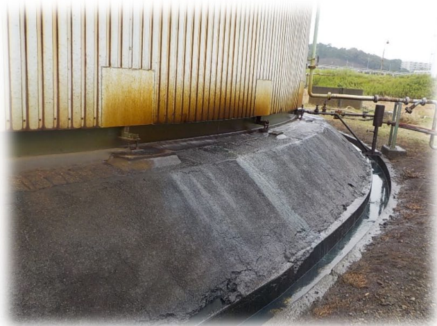
流出が認められたタンク東側
