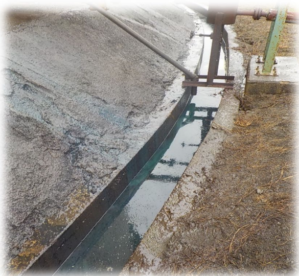
油が確認されたリング側溝
