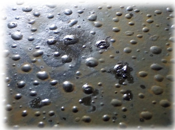
底部の全面に発生した膨れ
