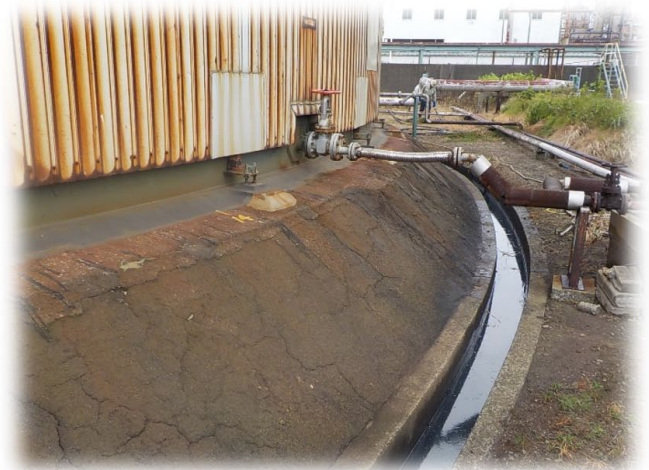
タンク北側 (流出なし)
