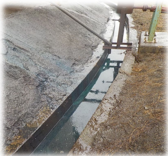
油が確認されたリング側溝
