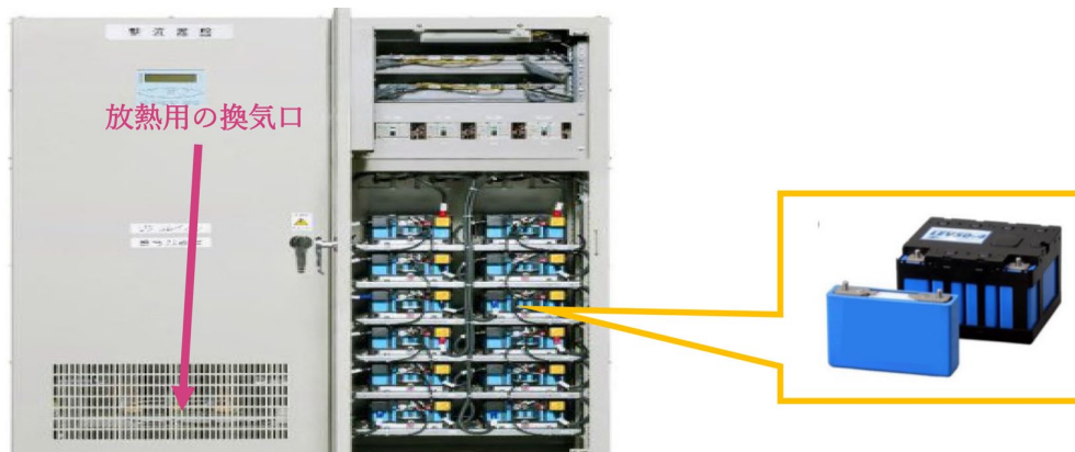
図4-3 キュービクル式リチウムイオン蓄電池
