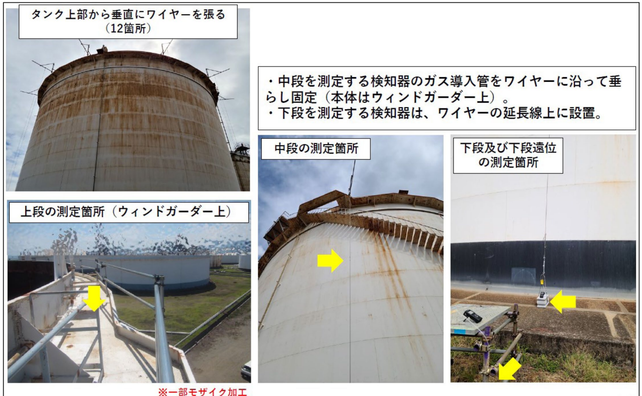
図2-5 ガス検知器設置状況 (浮き屋根を有する屋外貯蔵タンク)
