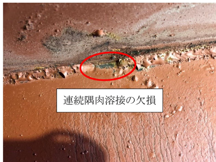
写真－4 ポンツーン内部の溶接施工不良の例
