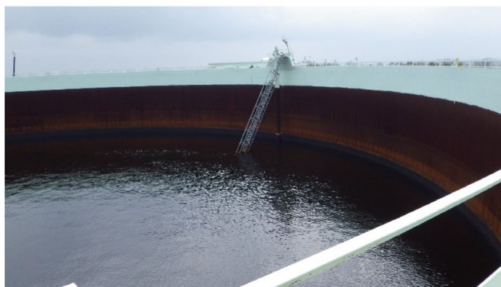
写真-2 浮き屋根沈没により液面が露出したタンク
