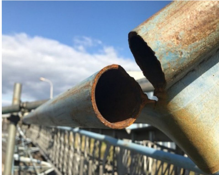
写真3 南側手すり破断部
