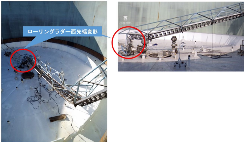
写真6 ローリングラダー西先端の変形状況
