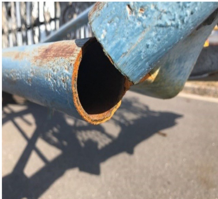
写真4 北側手すり破断部
