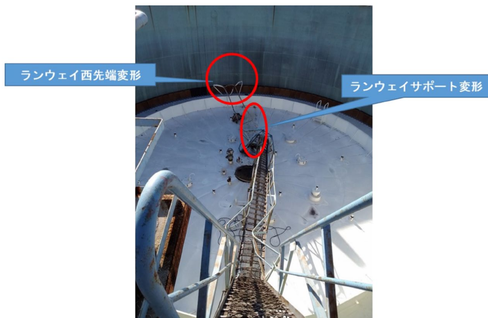
写真5 ランウェイサポート、ランウェイ西先端の変形状況
