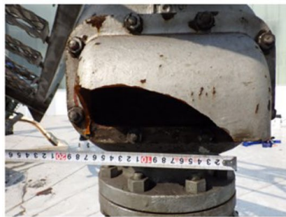
アトモス弁破損状況
