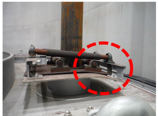
写真2. ゲージウェルの破損状況（点線赤丸）
