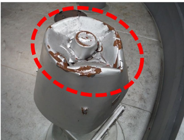
写真1. アトモス弁の破損状況（点線赤丸）
