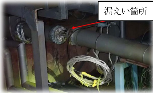
4月14日の漏えいの様子
