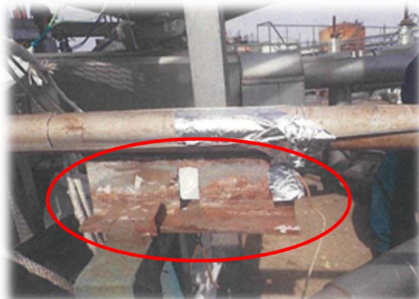
配管サポート写真
