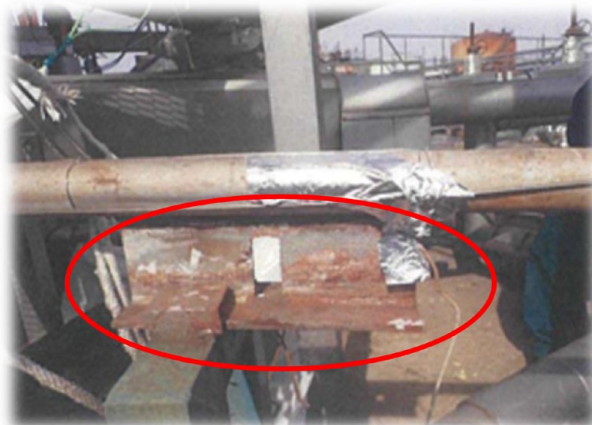
配管サポート写真
