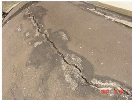
図5 犬走りアスファルトモルタルのクラック
