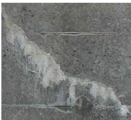
図2 コンクリート表面クラック部分からの白華現象
