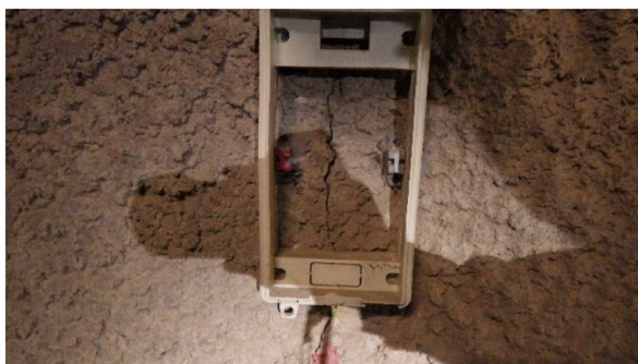
図 17 クラック幅測定点
