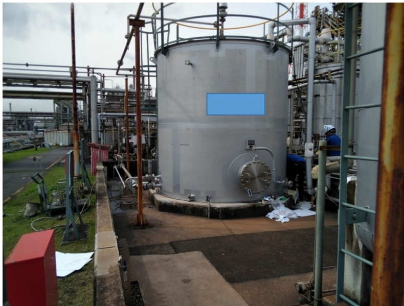
【写真1 危険物が漏えいした屋外タンク貯蔵所】
