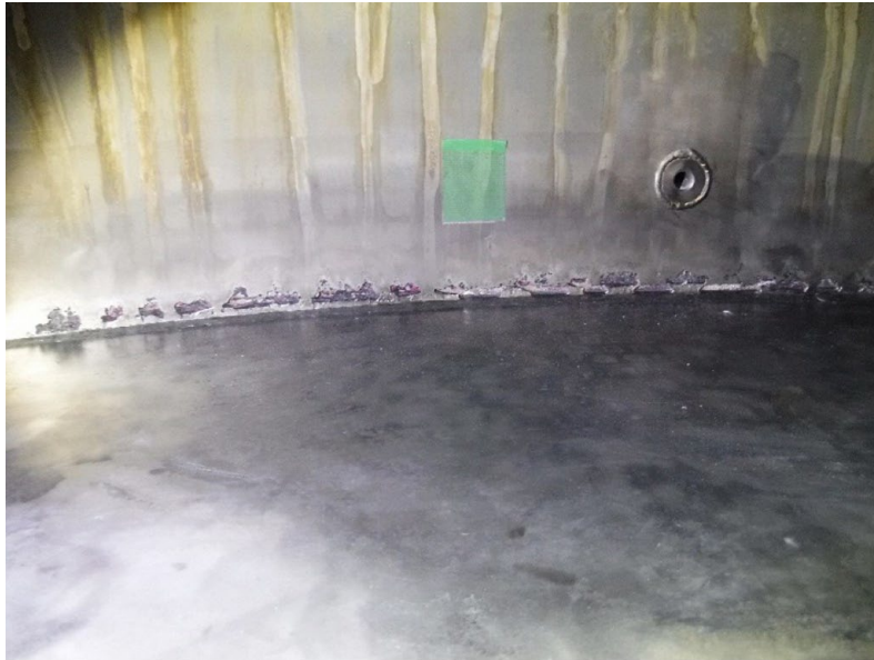
【写真7 隅肉溶接線近傍の腐食の状況】
