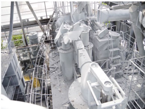
マルチサイクロン上部の損傷状況
