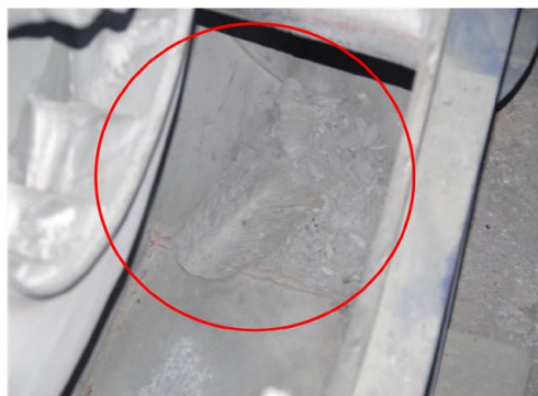
分級ファンから剥離した亜鉛スケール
