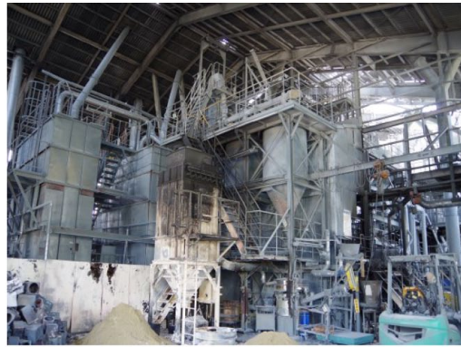
分級工程機器損傷状況(全体)
