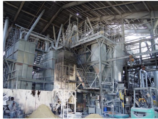
分級工程機器損傷状況(全体)
