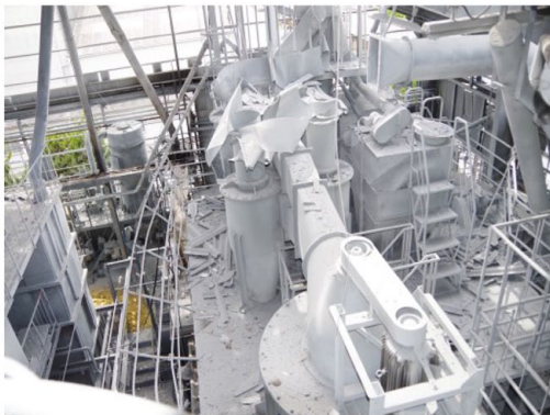
マルチサイクロン上部の損傷状況
