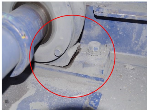
ベアリングボックス破断状況
