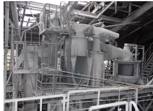
マルチサイクロン、セパレーターの損傷状況
