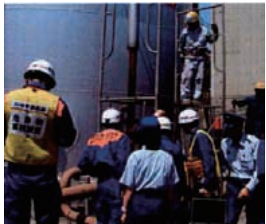
写真-2 流出確認状況
