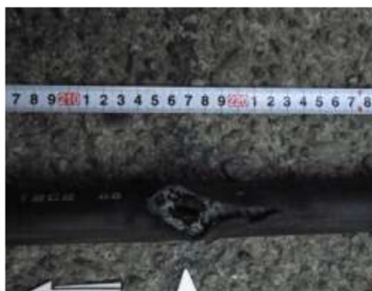
写真7 ノズルNo.3の給油ホース 損傷部分
