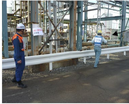
ペーハー計の異常と酢酸臭をもとに漏洩箇所を探す従業員
